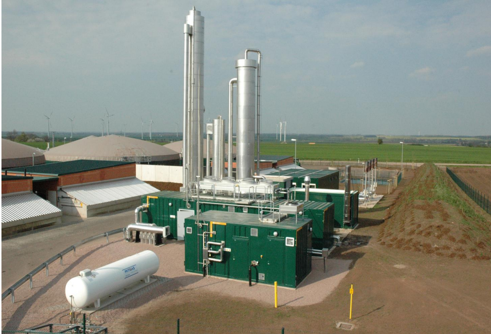
Malmberg 1250 m 3 /h water scrubbing system in Könnern (Germany)
